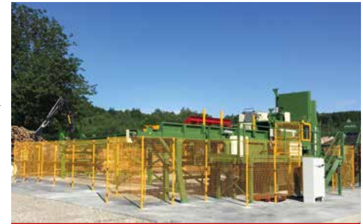
Sicherheitszaun um den Gefahrenbereich der Maschine
